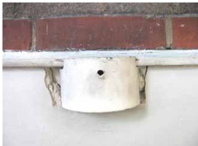
Skador runt kondensbehållare. Vasakyrkan.
