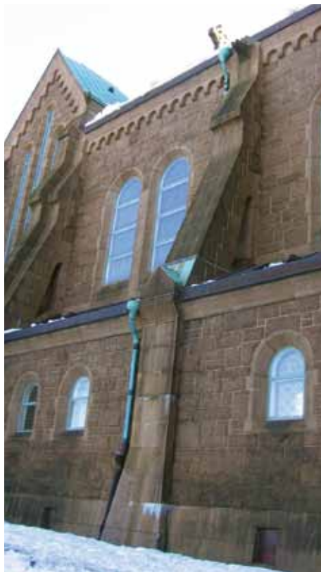
Skuggiga och läga fasadpartier uppvisar ofta smuts och biologisk påväxt. Vasa-kyrkan.
