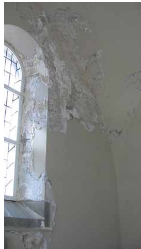
Fuktrelaterade skador på puts och yt-skikt i Vasakyrkans sydvästra trapphus.
