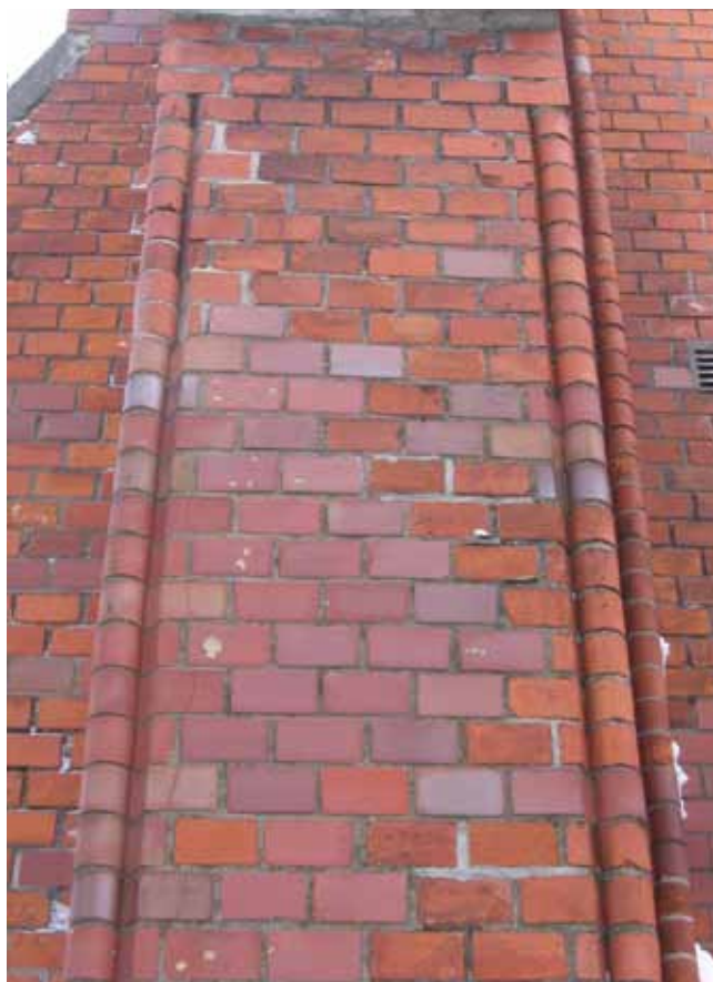
Foglagningar och utbytta tegelpartier på strävpelare i Örgryte kyrka.
