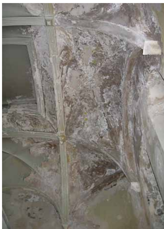
Massiva saltutfällningar och skador i trapphus åt söder i Anedalskyrkan.
