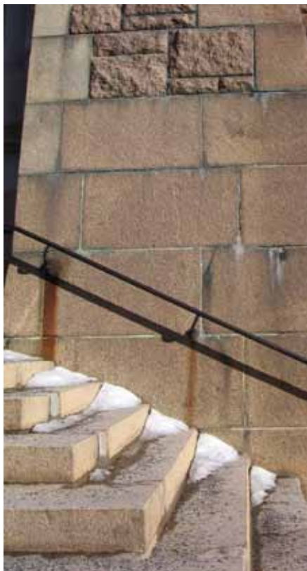
Fällningar av rost, koppar och salt eller kalk. Vasakyrkan.
