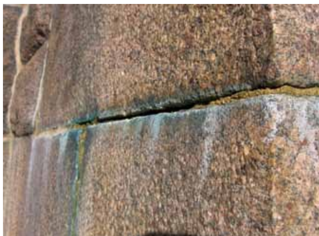
Urlakad och urfallen fog och fällningar. Notera hur smal fogen är. Vasakyrkan.
