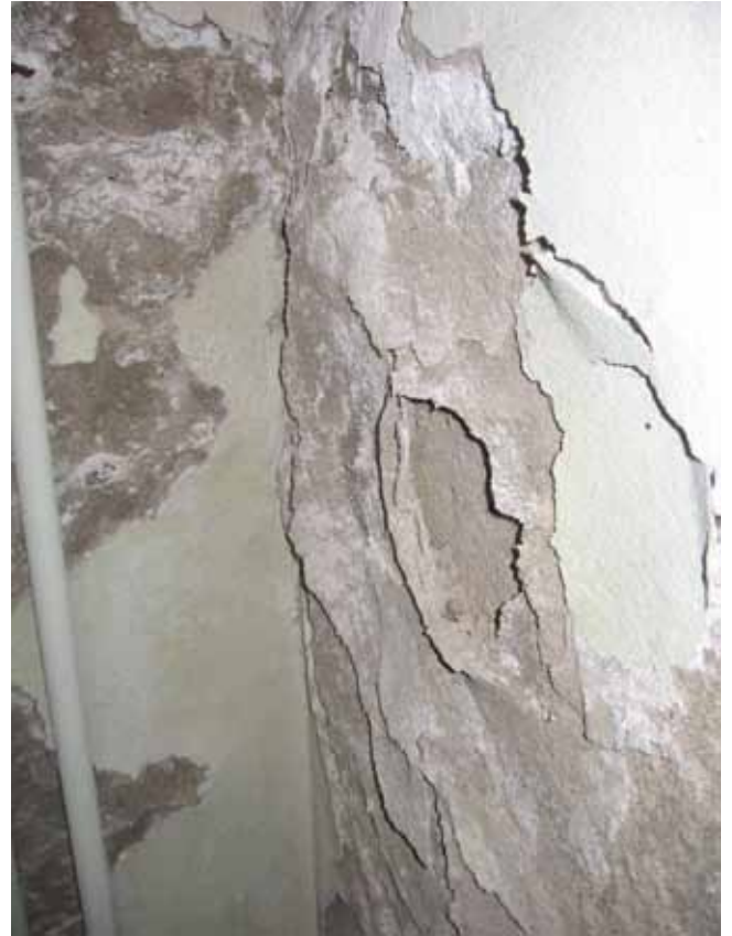
Kraftiga saltutfällningar och dess åverkan intill en varmvattenledning, Örgryte kyrka.
