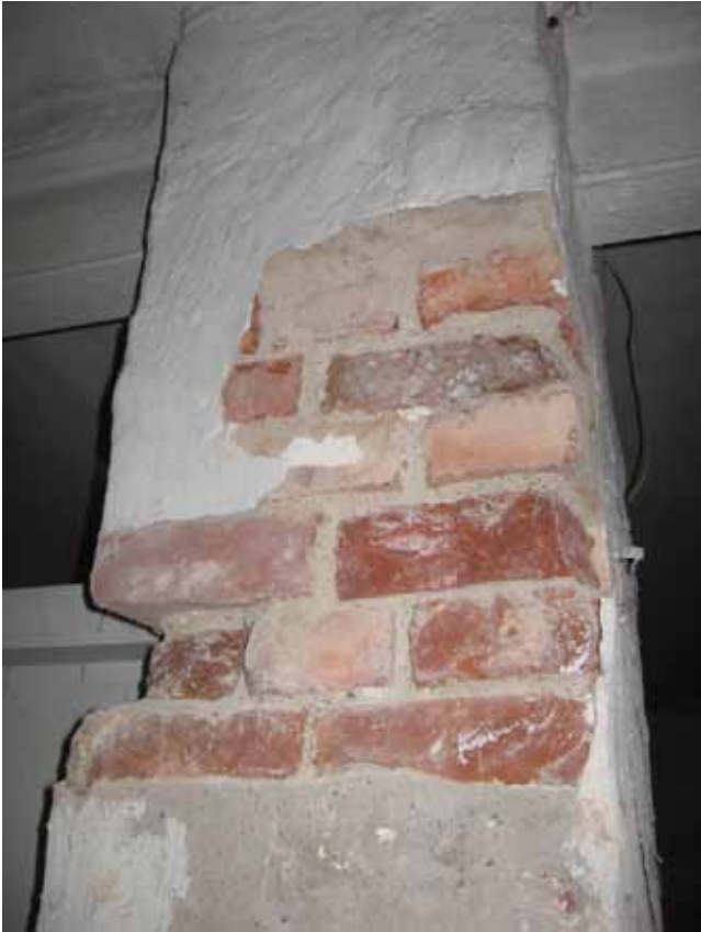
Fuktskadad källarpelare med förlorade tegelstenar, Örgryte kyrka.
