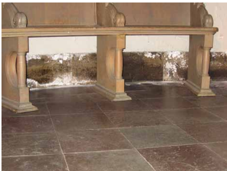
Saltutfällningar orsakade av fuktiga grundförhållanden, Annedalskyrkan.
