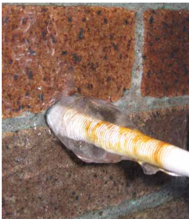
Issprängningsrisk vid infästning av stuprör, Annedalskyrkan.
