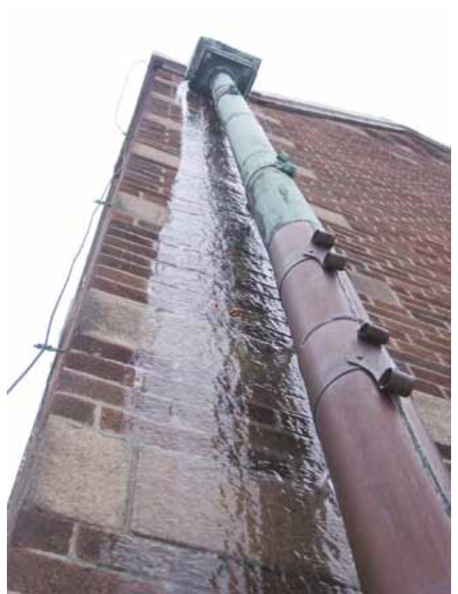
Stopp i stuprör har orsakat en isbegjuten fasad, Annedalskyrkan.
